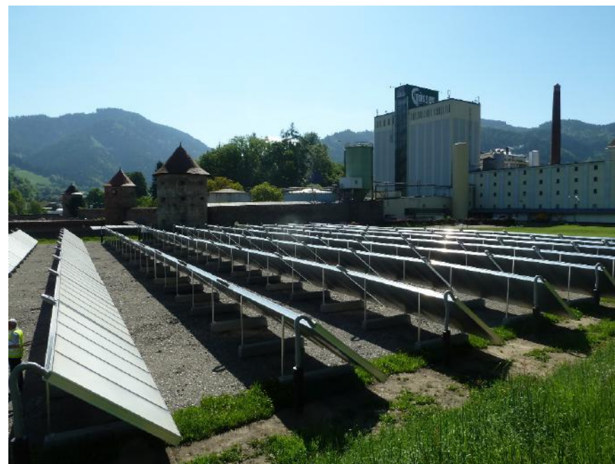
Chaudière solaire pour la brasserie de Göss
